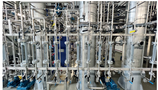
Die fünf Destillationskolonnen des Schweizer Ethanols in der Produktionshalle der Zuckerfabrik in Aarberg BE.
